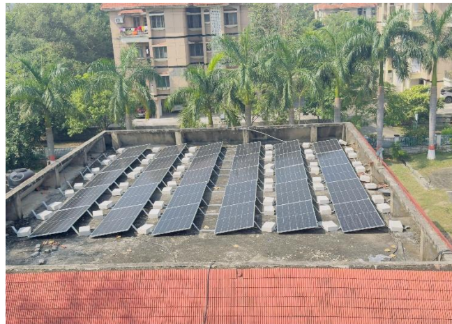
5) Vaishali club 30 KWp
